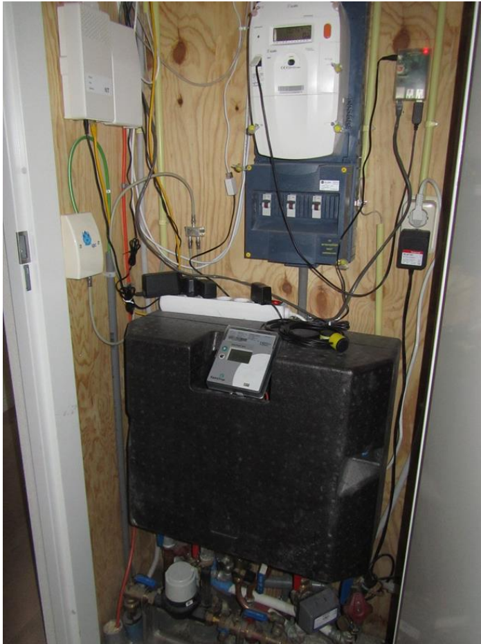
Figuur 3.2 Plaats van een warmteafleverzet in de meterkast, de zwarte omkasting is isolerend
