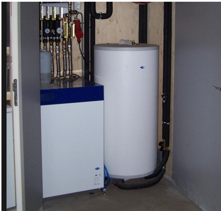
Figuur 3.1 Warmtepomp (links) met een boiler (rechts)
